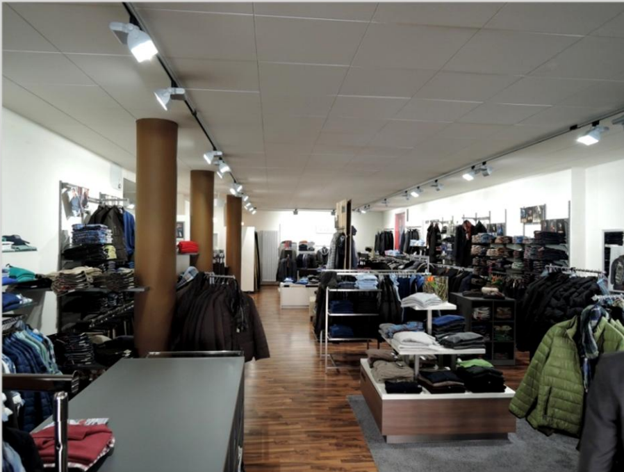
Beleuchtung eines Textilien-Verkaufsbereichs mit YES-3-Phasen-Strahlern
