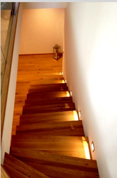
Typische Installation an jeder dritte Stufe
