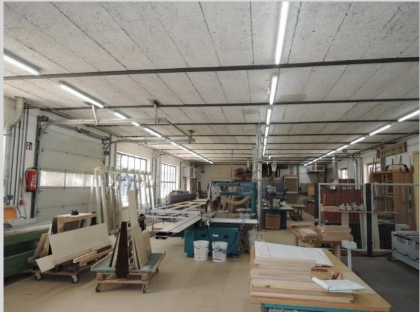
Werkstättenbeleuchtung mit YES-LED-Tubes in Wannenleuchten
