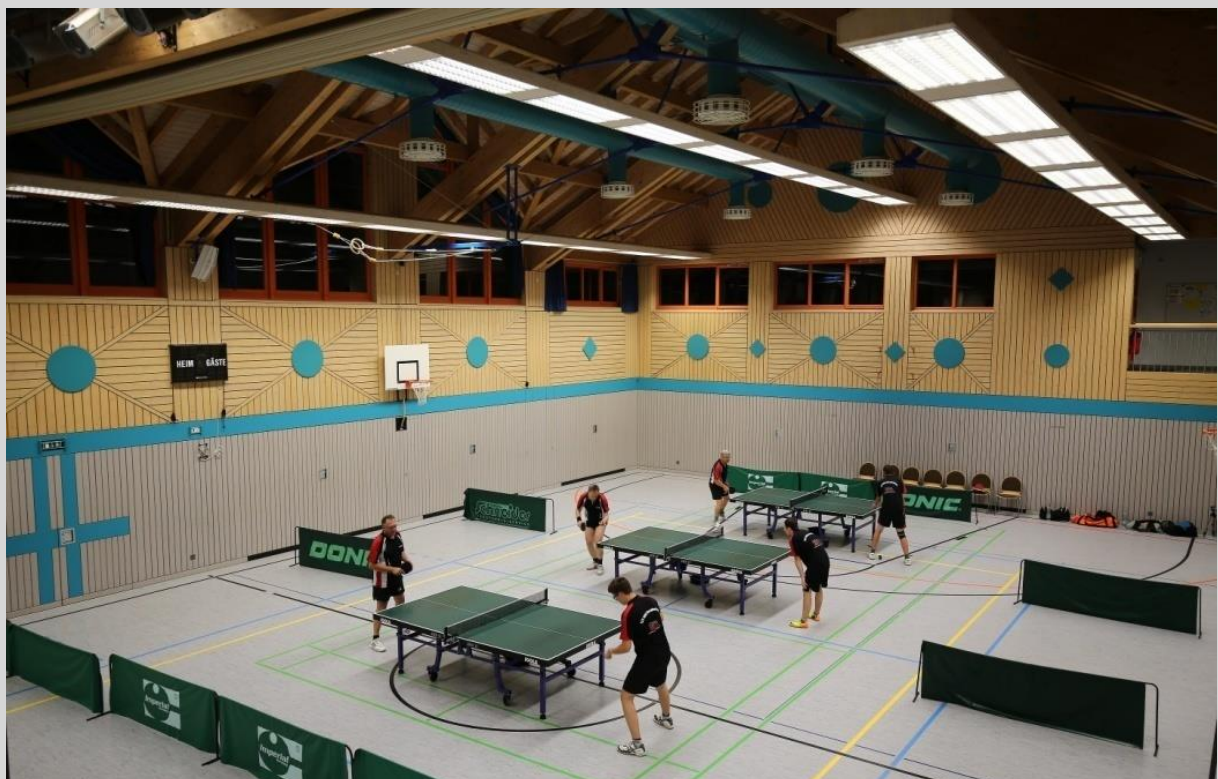
Umrüstung Turnhalle mit YES-LED-Tube-150-6K
